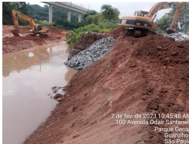
FIGURA 2 – EROÇÃO IDENTIFICADA E TRATADA
