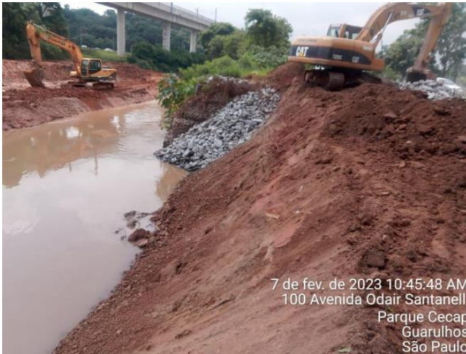
FOTO 2 – EROSÃO IDENTIFICADA E TRATADA
